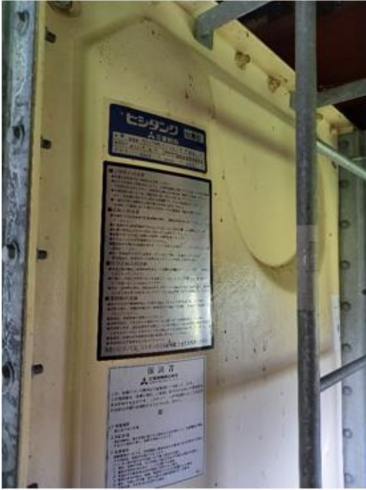
中間受水槽 20m 3
