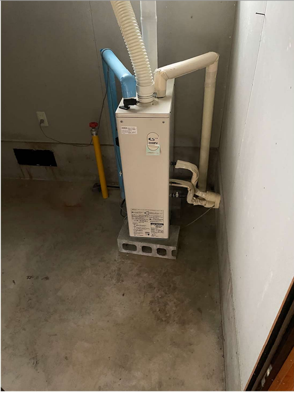
13_物置・ボイラー.jpg
