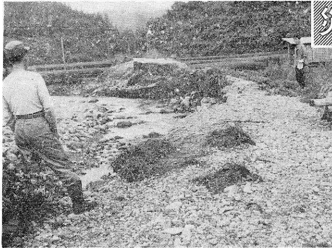
復旧を待つ被災地、荒瀬川村地内の欠壊道路
