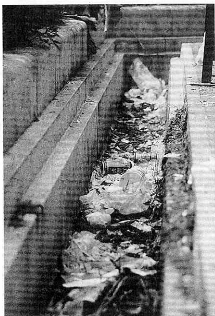
比立内繁沢チェーン着脱場の側溝に捨てられた空き缶などのゴミ
