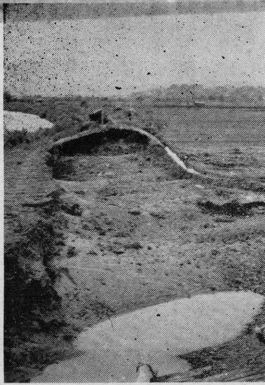
堤防の破損はいたるところにあり、むしろ完全な堤防が破損箇所より少なくなつたと云う状況である。——阿仁川沿岸——
