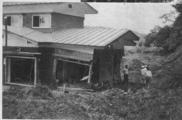
◆がけくずれ、住家を半壊・雨により地盤がゆるみ土砂が住家に流入、家屋半壊(芹沢)
