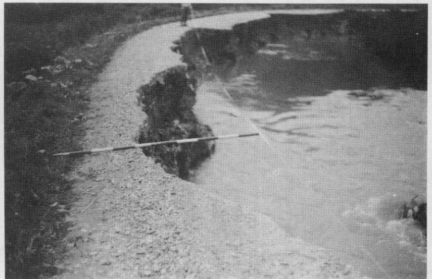
◆もぎとられた路肩・濁流により延長210mも路肩をもぎとられる。(町道羽根山沢線)
