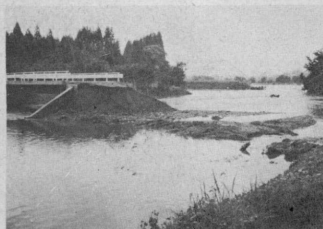
河川、道路、橋梁の土木関係は322,650千円 (大内沢川、根田2号橋の道路欠壊)
