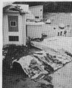
西小学校の屋根、飛ば
