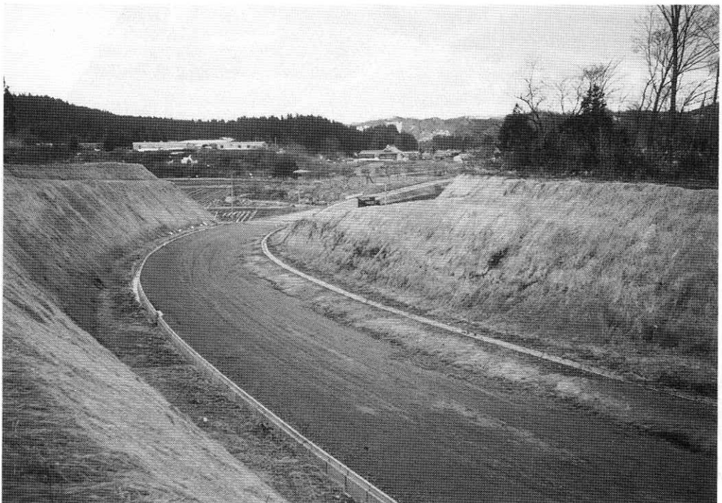
県道三木田バイパス（手前）から鎌沢バイパスへと工事が進む
