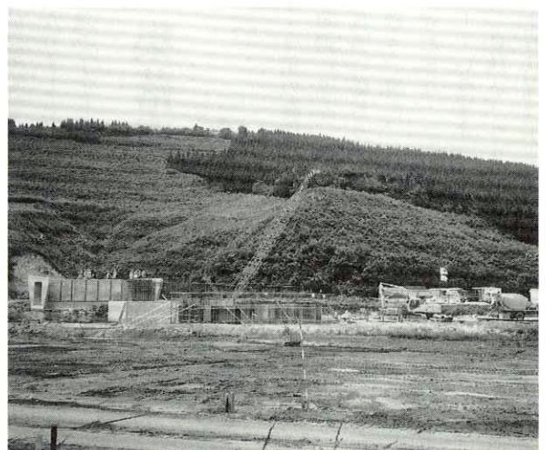
トンネル掘削に向け大がかりな工事が 行われている増沢地内
