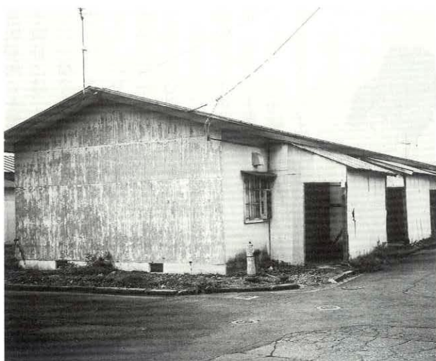
老朽化が進む町営田の沢住宅
