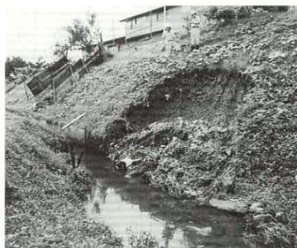
人家裏の法面が約二十メートル崩落（増沢地内）
