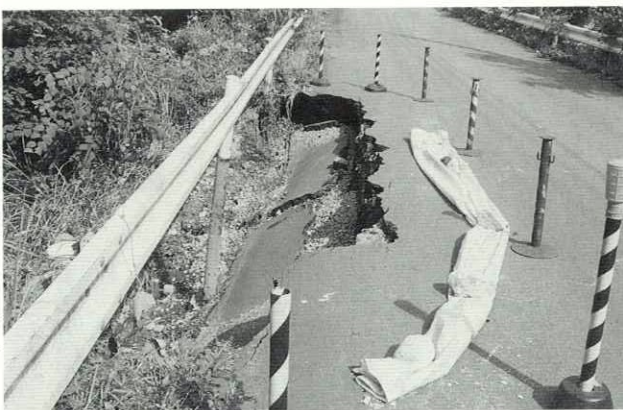
→陥没した町道大野台中央線
