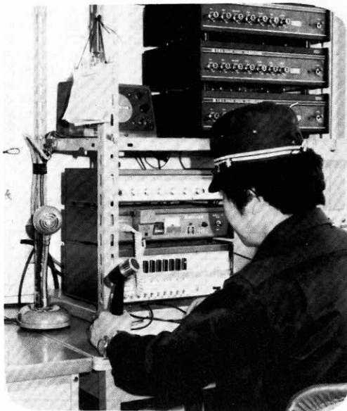
連絡・指令の通信室
