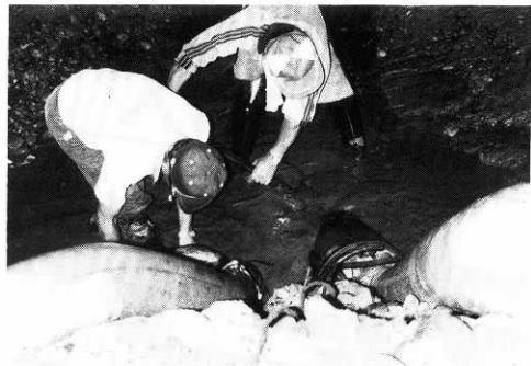
水を確保するため夜を徹しての作業が続いた(小猿部川)
