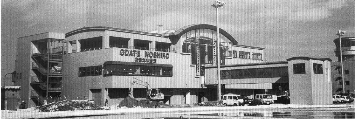
本年7月の開港に向けて工事が進められている「あきた北空港」ターミナルビル
