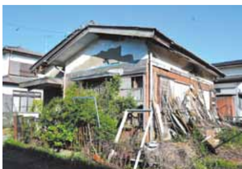
倒壊の危機がある建物!!
