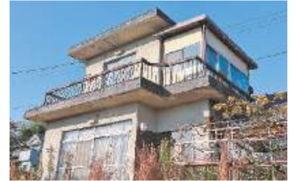
放置された空き家
