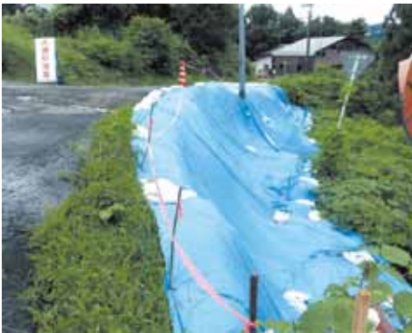
究明が必要な合川集落の法面崩落
