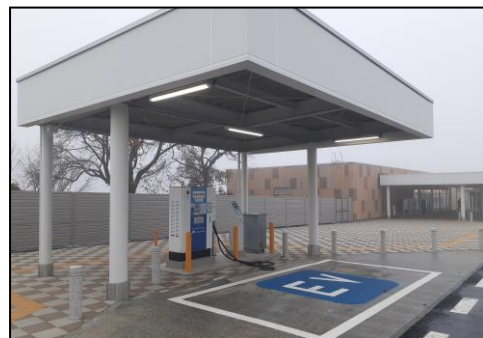
電気自動車充電設備
