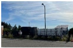
⑥防災拠点設備 H23年度 (貯水槽・非常用発電機)
