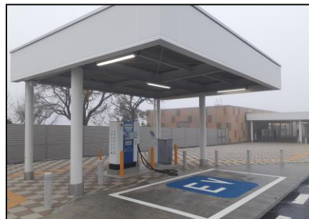
電気自動車充電設備
