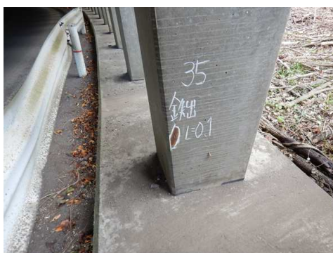
谷側柱 35 剥離・鉄筋露出「II」
