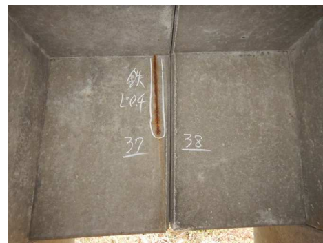
横梁 37 剥離・鉄筋露出「II」
