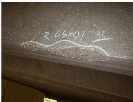
主梁 36 変形・欠損「II」
