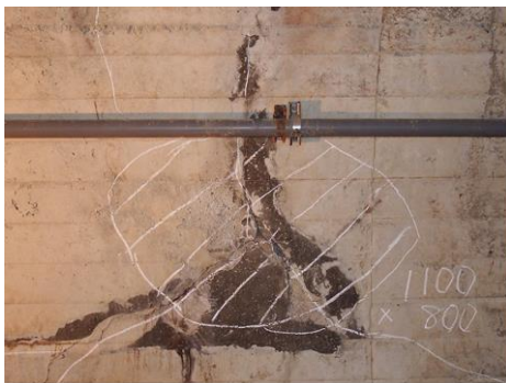
覆工（7-チ）のうき「Ⅲ」
