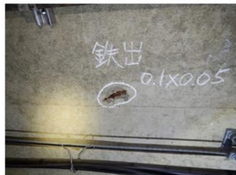
覆工（7-チ）の鉄筋露出「Ⅱa」
