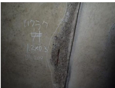
覆工（7-チ）のはく落「Ⅲ」
