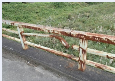
防護柵の変形
