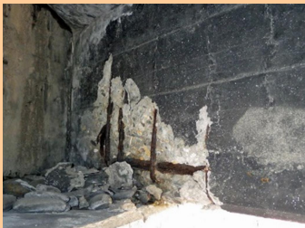
主桁の鉄筋露出
