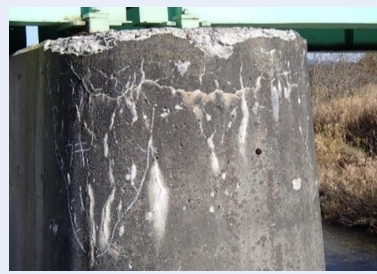
遊離石灰の析出
