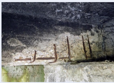
剥離・鉄筋露出
