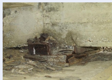
支承の機能障害
