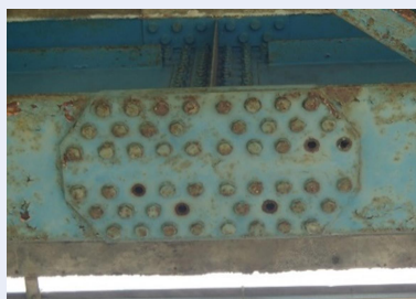
ボルトの脱落
