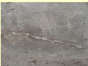
床版の遊離石灰を伴うひび割れ
