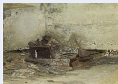
支承の機能障害
