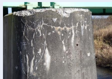
遊離石灰の析出
