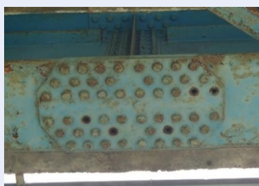
ボルトの脱落
