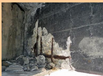
主桁の鉄筋露出
