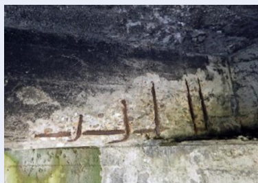
剥離・鉄筋露出
