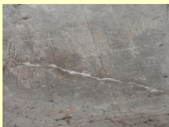
床版の遊離石灰を伴うひび割れ
