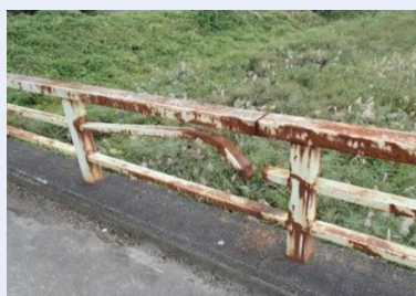
防護柵の変形
