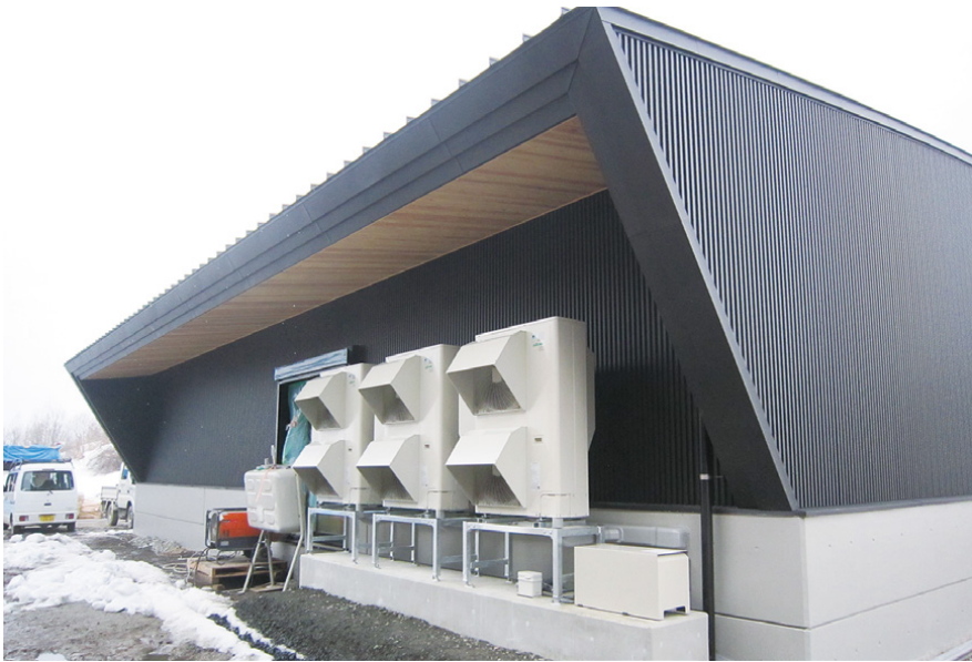
建築空調室外機
