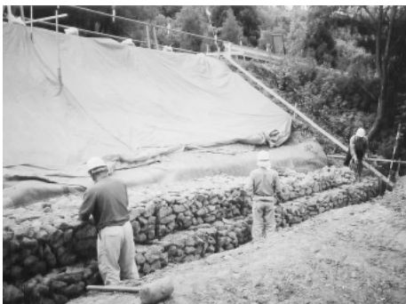
▲市内各所で順次進められ、すべての事業が完了した豪雨による災害復旧工事
