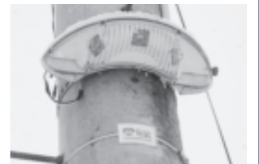
設置されたLED防犯灯
