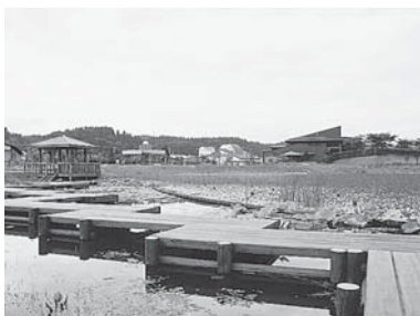
汚水対策を要する釜堤
