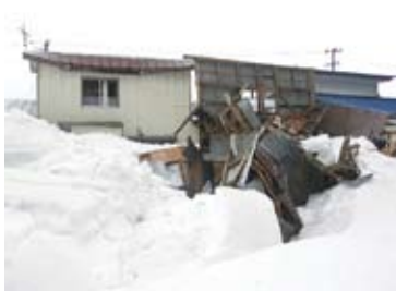
▶積雪で倒壊した空き家
