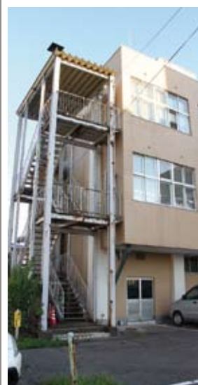
老朽化が目立つ非常用階段
