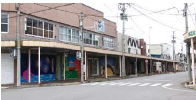
老朽化したアーケード
