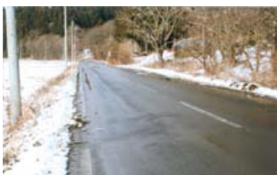
通学路未整備の川井八幡岱間
