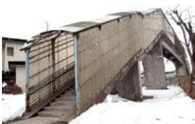
対策が求められる元町跨線橋
