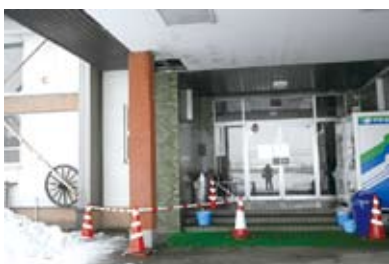
雨漏りした七日市公民館
