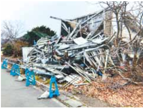
危険防止が必要な空き家
