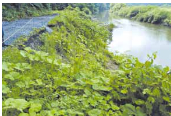
整備計画ない林道崩落箇所
