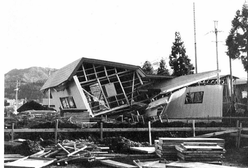
▲ あまりにも無残！新築中の住居が崩壊
