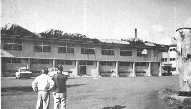
▶ 森中体育館の屋根もご覧のようにめくれあがった
