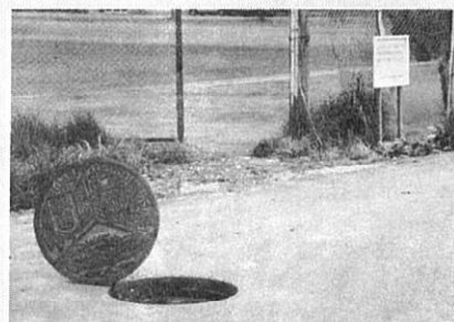
▲公共下水道(川向地区)
