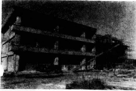
▲南小学校建築第2期工事 本體工事がすすめられています。
